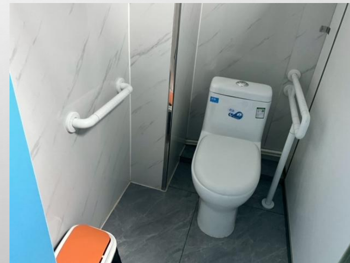
障がい児トイレも設置
